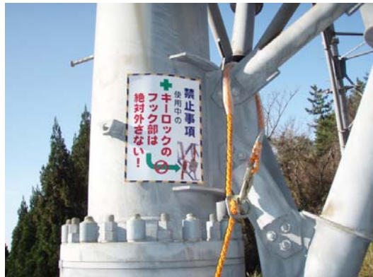
③キーロック方式安全ロープ使用において安全ロープの取付フックを勝手に取り外さないよう注意喚起する標識
