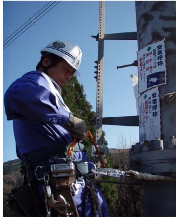
②キーロック方式安全ロープ使用において昇降用安全器に取り付けられた小綱が等がキーに確実に挿入されたことの確認、昇降時の安全呼称を促す注意喚起標識
