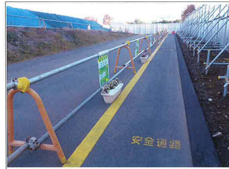
ヘルメット不要な安全通路です。 ①バリケードの向こう側はヘルメットが必要です。
