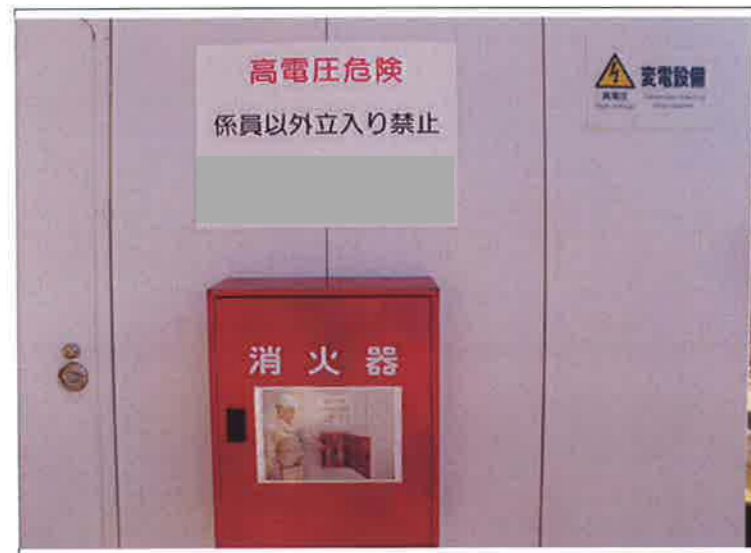
消火器も内部が分かるように 表示しています。
