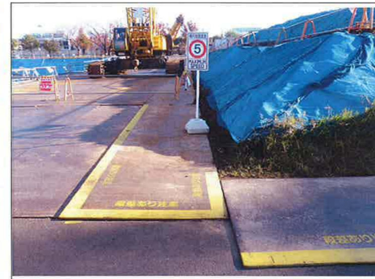
鉄板の段差があります。 ①つまづきに注意
