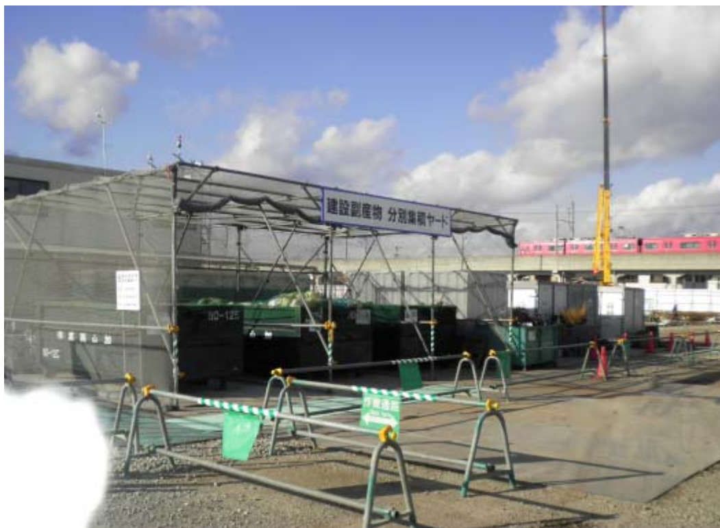
外部の安全通路の明示
