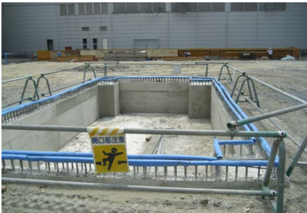
ピットの開口看板と鉄筋の色付養生材による注意喚起
