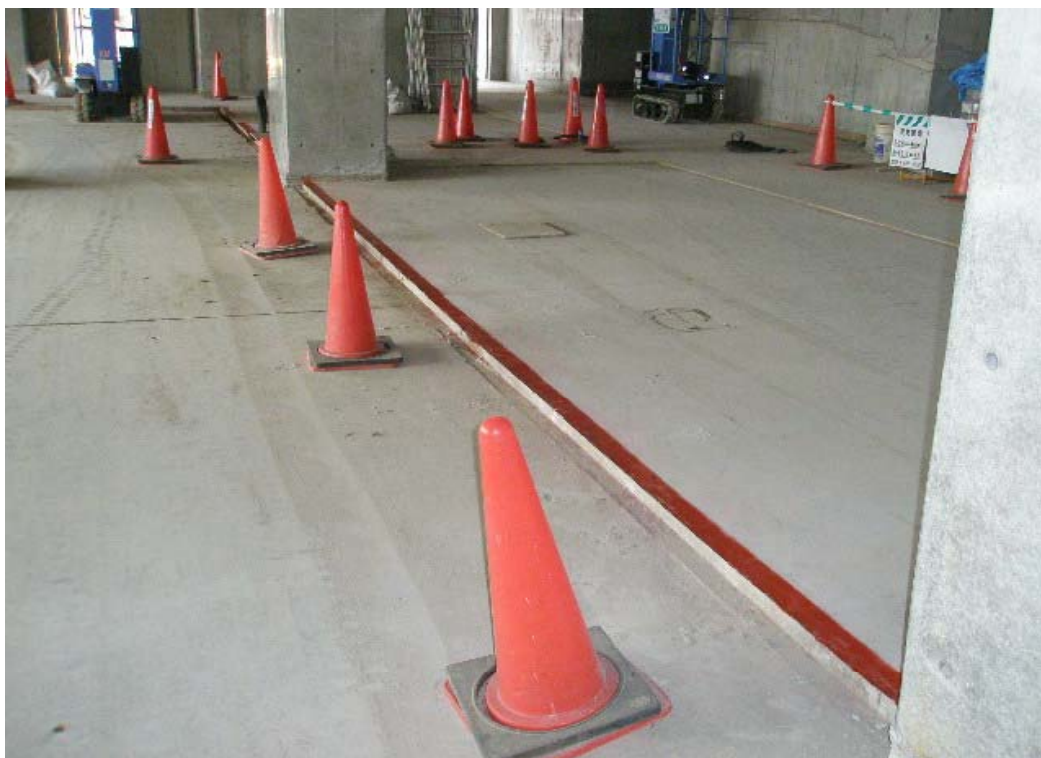
床の段差部の注意標示
