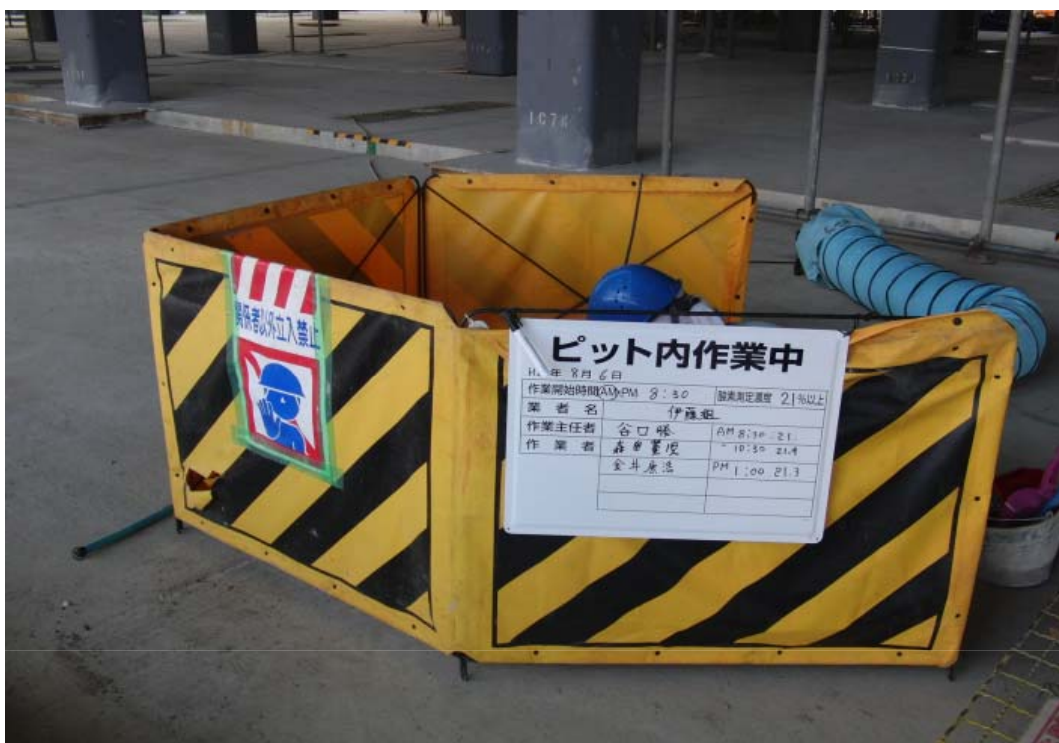
室内ピット内の作業中注意標示
