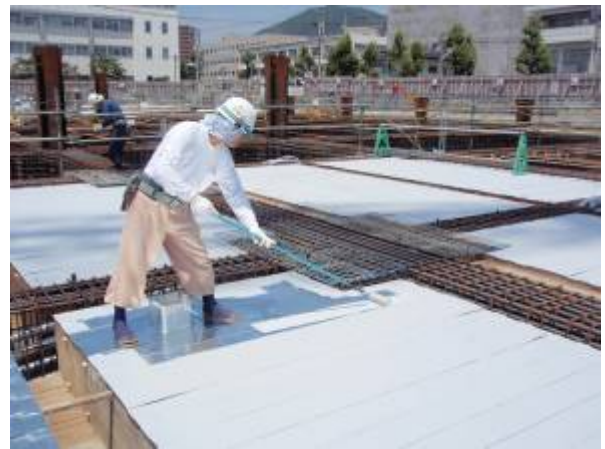
写真-12 デッキスラブの照り返しとスリップ防止
