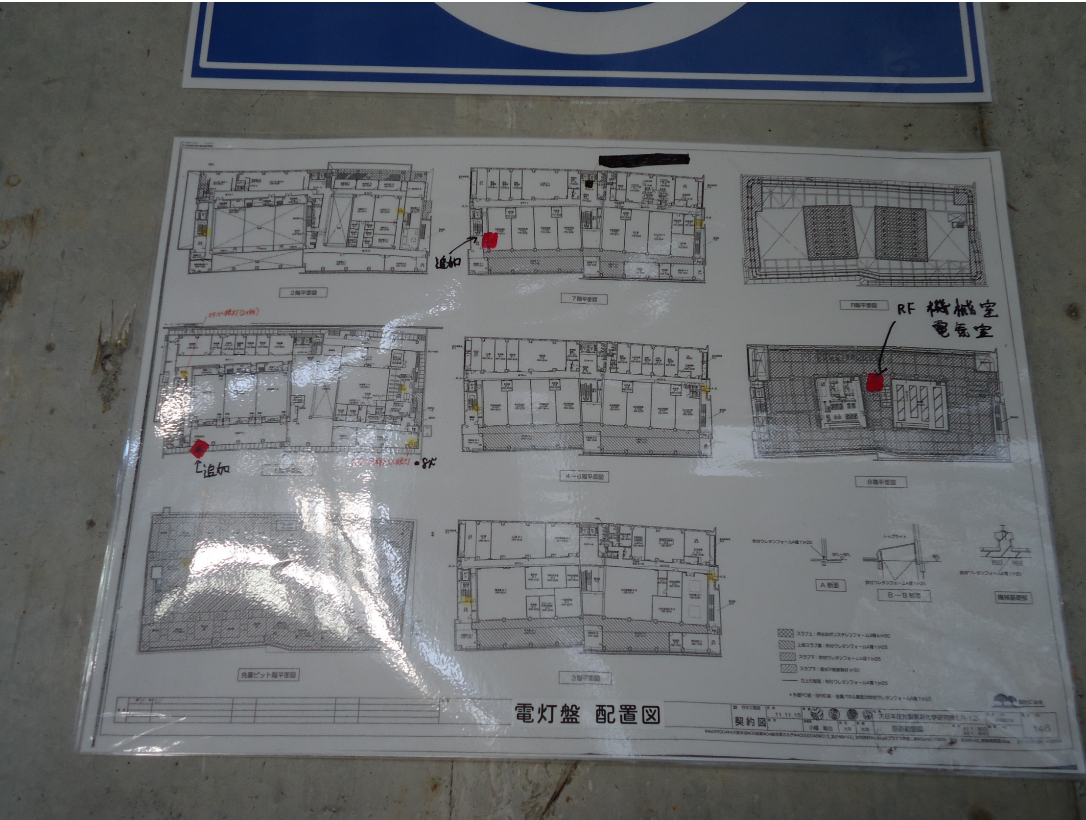
メイン階段の各階の踊り場に電灯盤配置図を掲示し、どこに電灯盤があるのかを一目で分かるようにした
