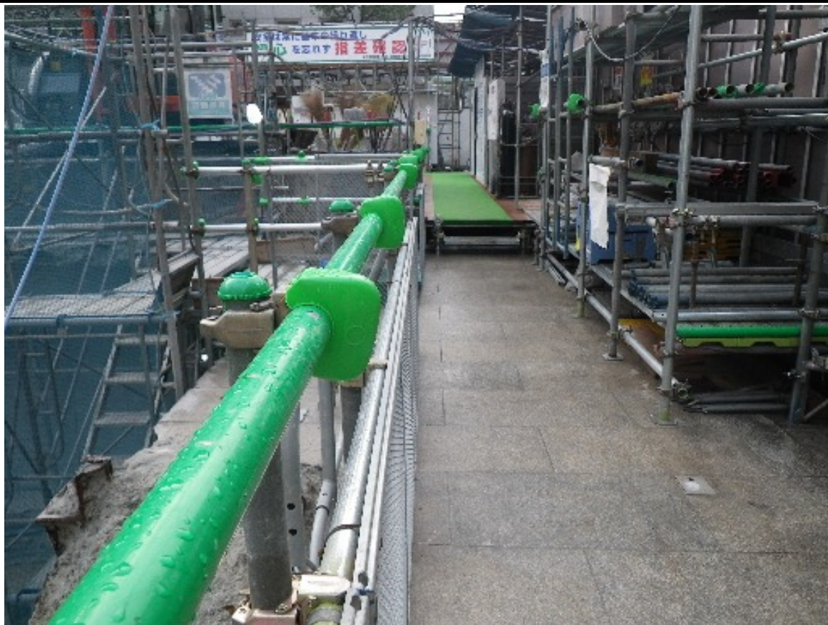
作業通路 手摺のカラー表示
