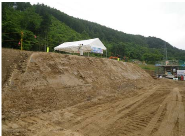
① システムの設置状況
