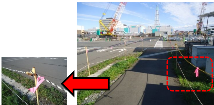
通路の視認性の向上のため蛍光色テープ貼り
