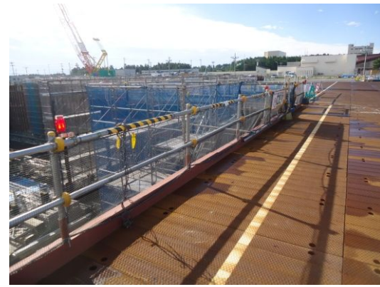
対策 端部に赤色ライト設置
