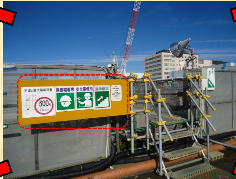
足場の制限荷重表示等
