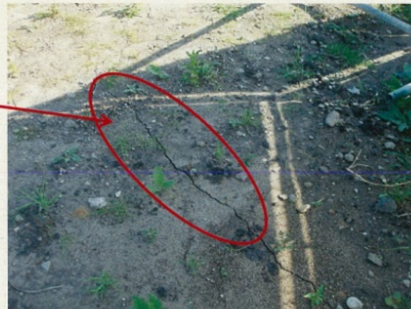
箱型擁壁の上部 亀裂、単なる沈下と思うが 留意しておくこと
