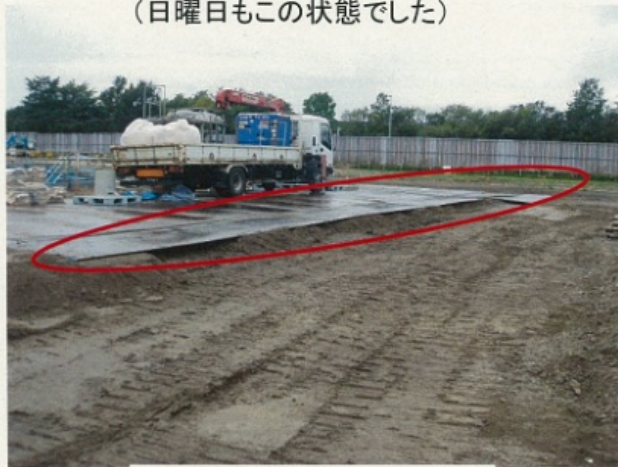
敷鉄板端部土が抜けている 幅に余裕を持たせる
