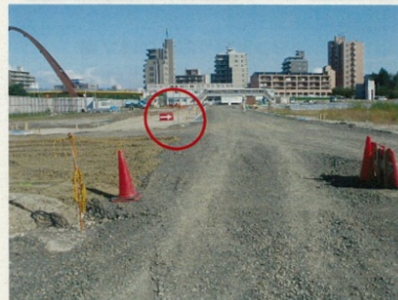
安全通路が途中で切れています。 何かで区画して歩道を明示してください
