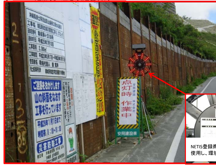
起点側 注意喚起警告灯
