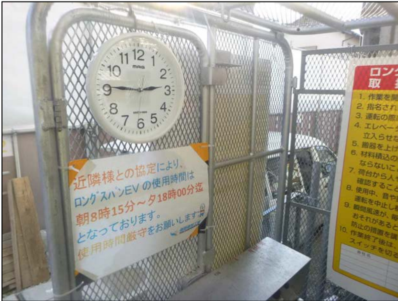
④-2 ロングスパンエレベーター操作台正面に 近隣協定による使用時間の掲示と 時計の設置状況拡大写真
