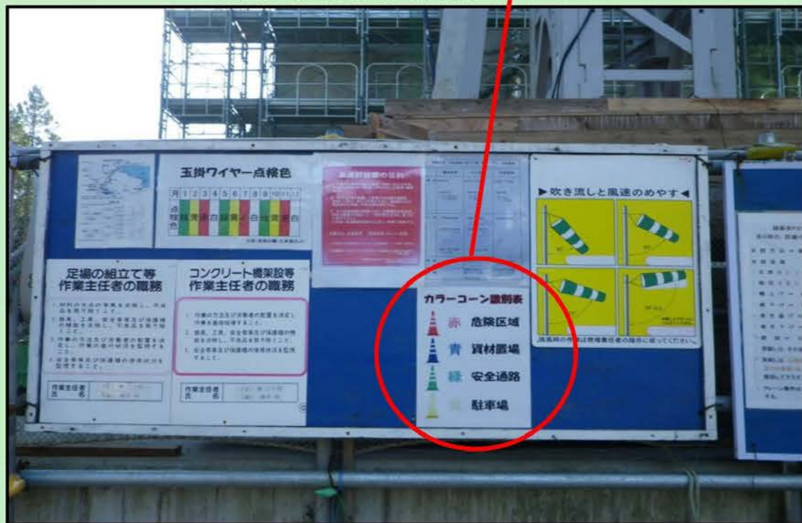
カラーコーン識別表掲示状況
