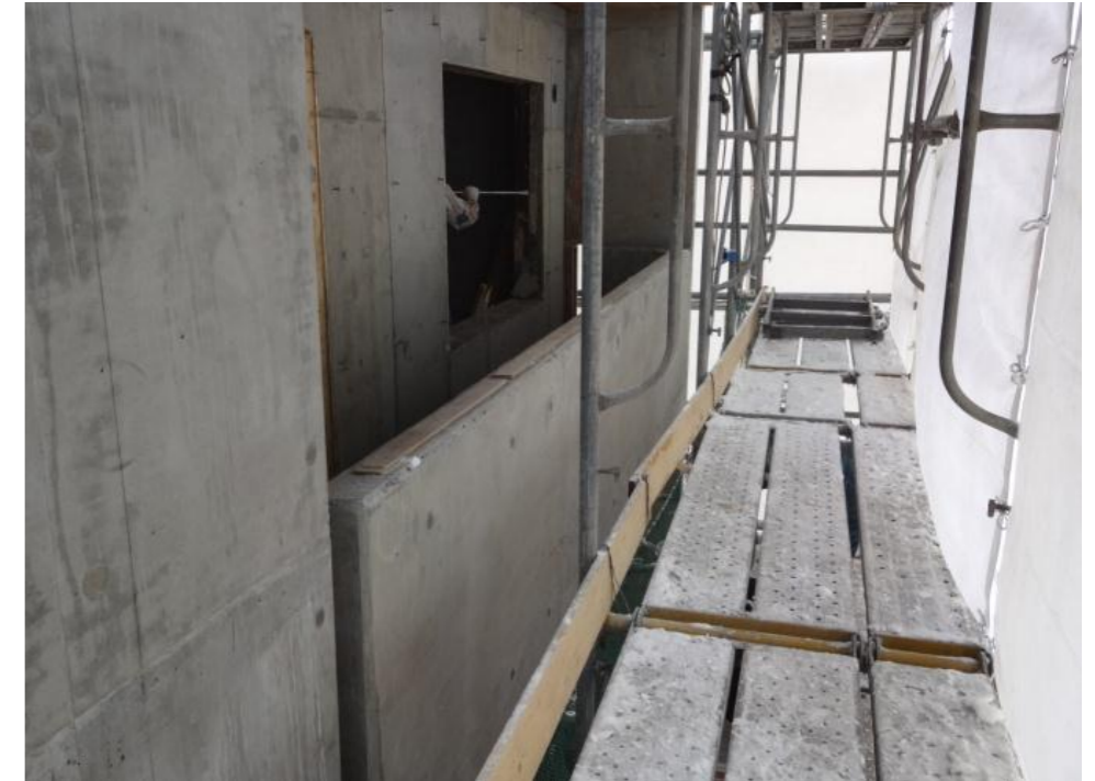
筋違いが欠落している
