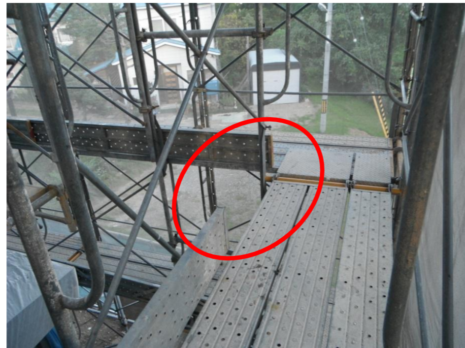
巾木が一部欠落している
