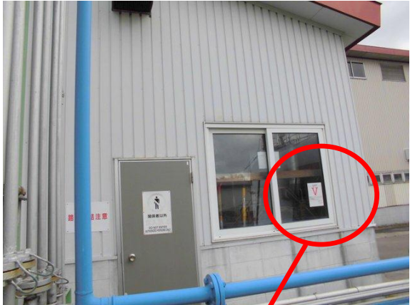
落雪危険箇所
