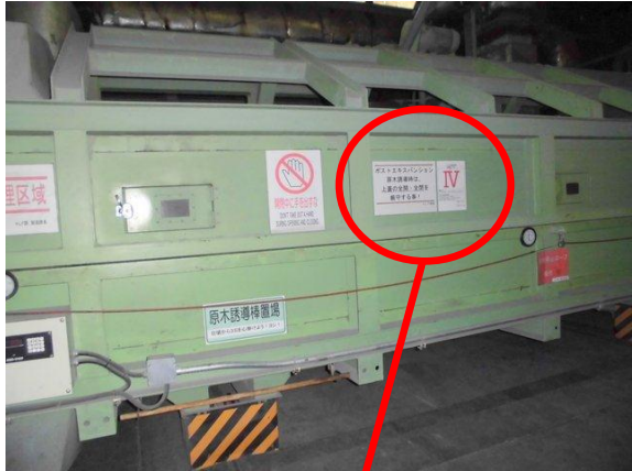
挟まれ危険箇所
