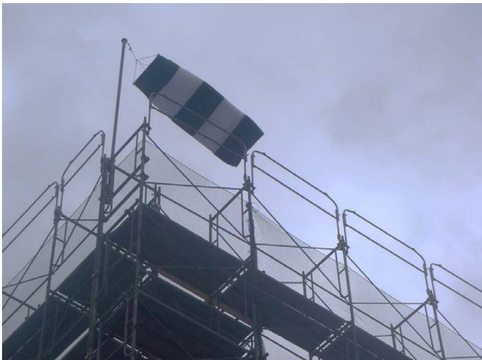
地上20m付近に設置
