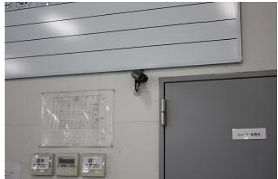
④扉上部据え付けのカメラ
