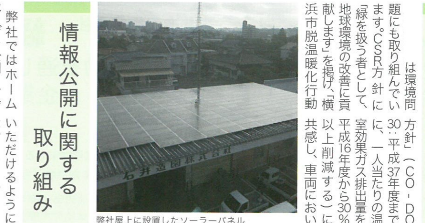
弊社屋上に設置したソーラーパネル
