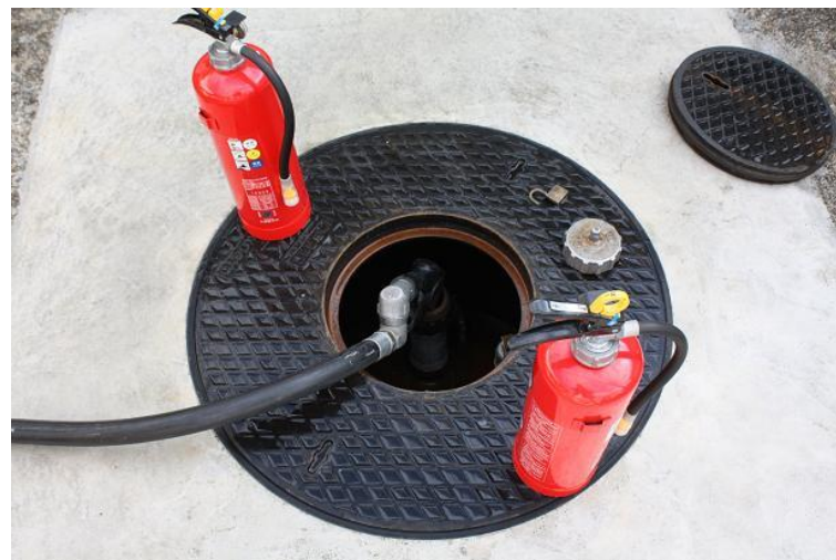
地下灯油タンクへの給油中に発生する静電気にて火災の可能性
