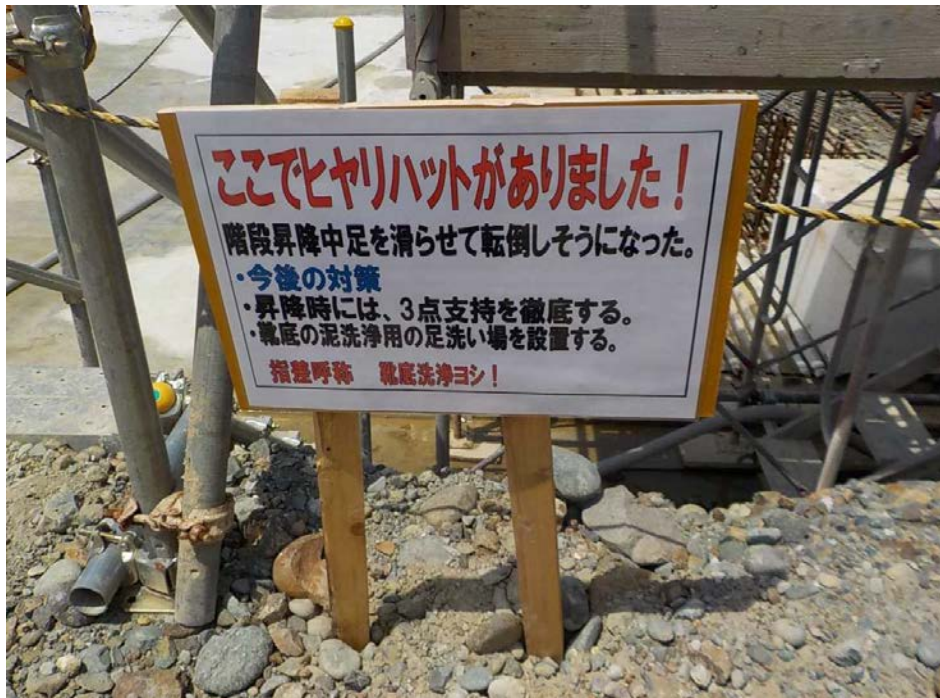
ヒヤリハット発生箇所への注意点明示
