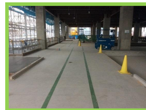
安全通路（緑）とカラーコーン （黄）による段差表示
