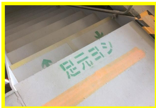
昇降階段に段差表示の線 （黄）と「足元ヨシ」の表示
