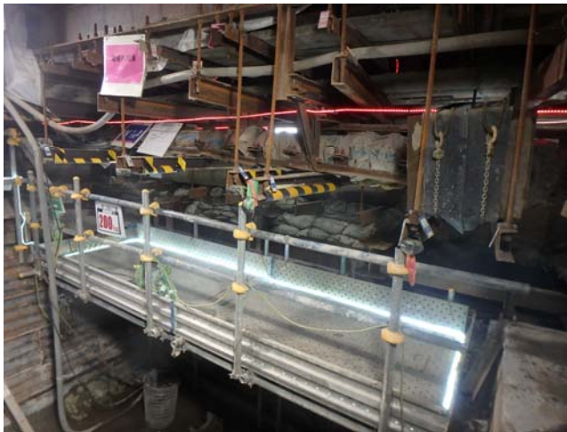
路下でのLED照明による動線明示
