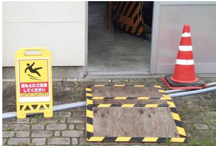
建物出入り口 (施工用ホース横断部見える化・養生状況)
