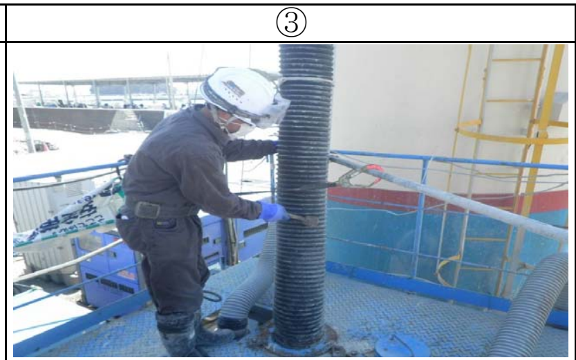
③ ジャバラをたたいてホース内のセメントをミキサー内に落とす。
