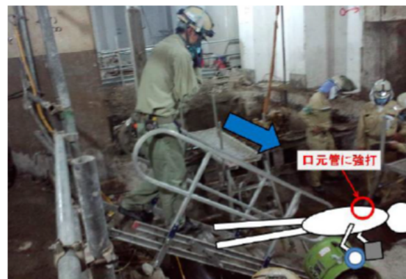
昇降階段での踏み外しによる転落
