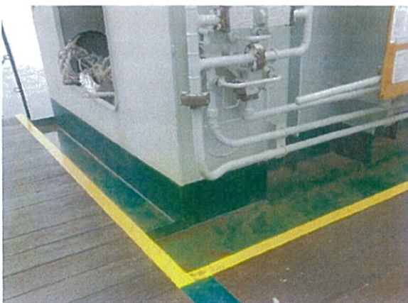
機械・タンク類周りのコーミング部分 段差の黄色ペンキ表示
