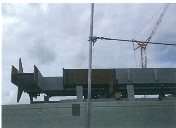
親綱取付設備の単管パイプ 荷に合わせてクランプ固定しています。
