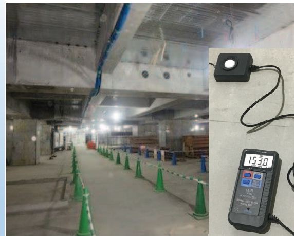
安全通路の明示と十分な照度の確保
