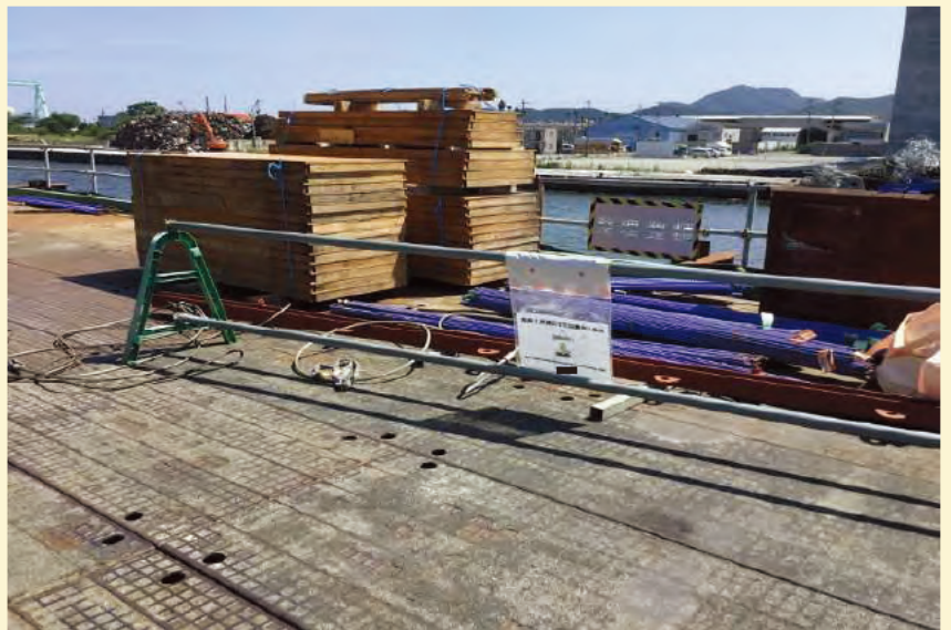
【危険！吊荷の下には絶対入るな】
