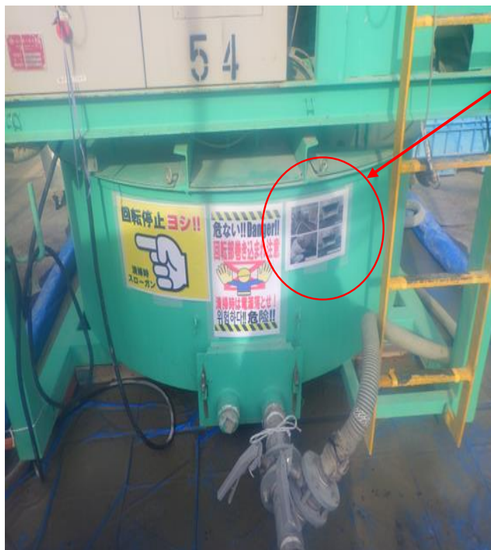
造成機の巻き込まれ災害事例
