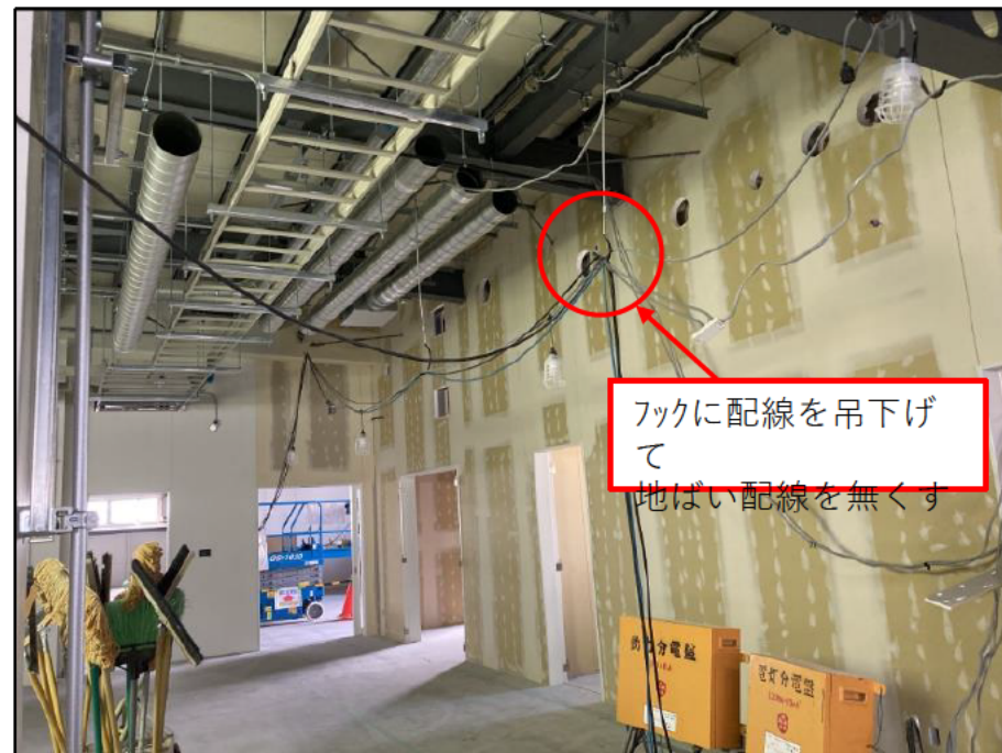
地ばい配線対策用フックの設置
