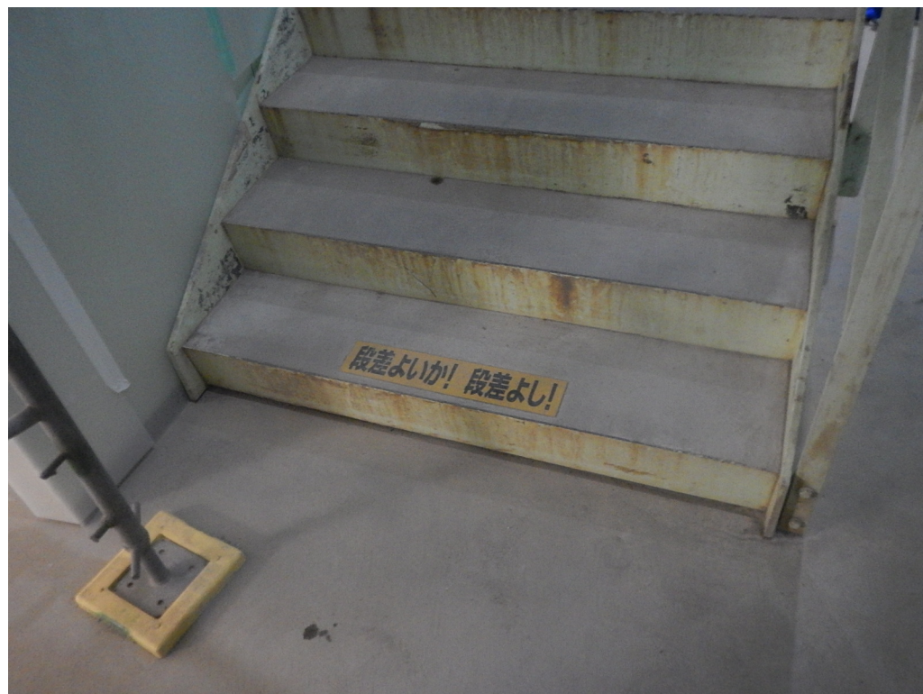
◀建物内部の階段にも「段差よいか! 段差よし!」のテープを貼り踏面をわかりやすく見える化し、注意喚起を促しています
