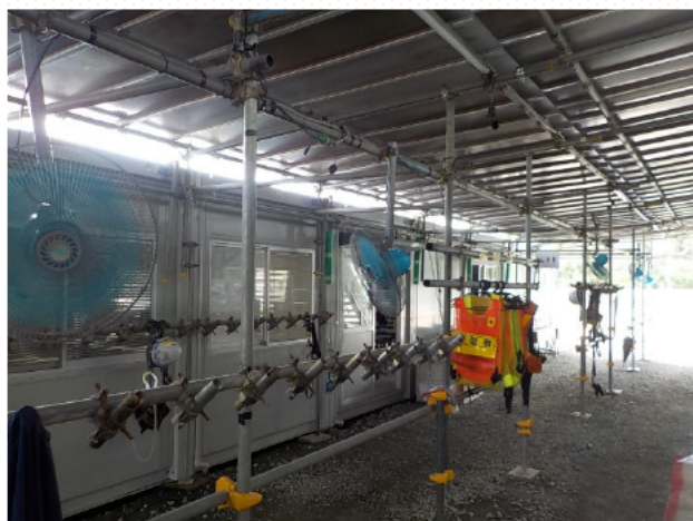
■共用部に扇風機設置
