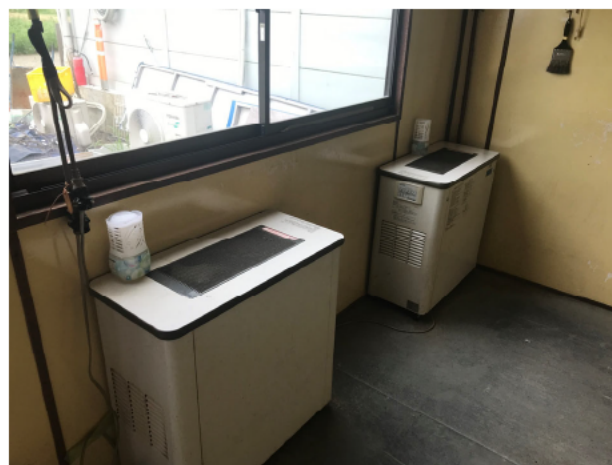
喫煙所内に集塵機
