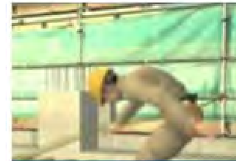
02施工中の床端部から墜落
