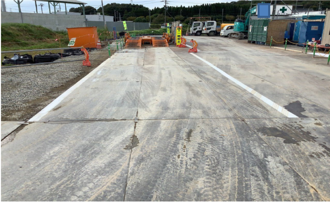
洗車機前のダンプトラック誘導路の区画線明示
