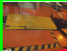
静検コイル側スライディングデッキ閉の状態
