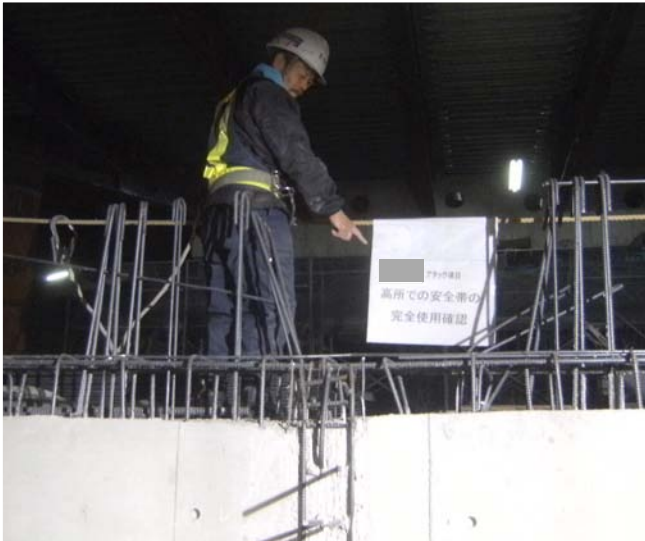
高所はつり作業時の 安全帯使用徹底確認表示
