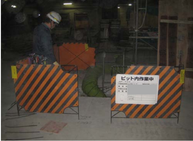
ピット上部立入禁止表示状況と見える化看板
