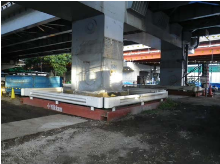
①橋脚への近接防止作の設置状況(ガードレール柵)
