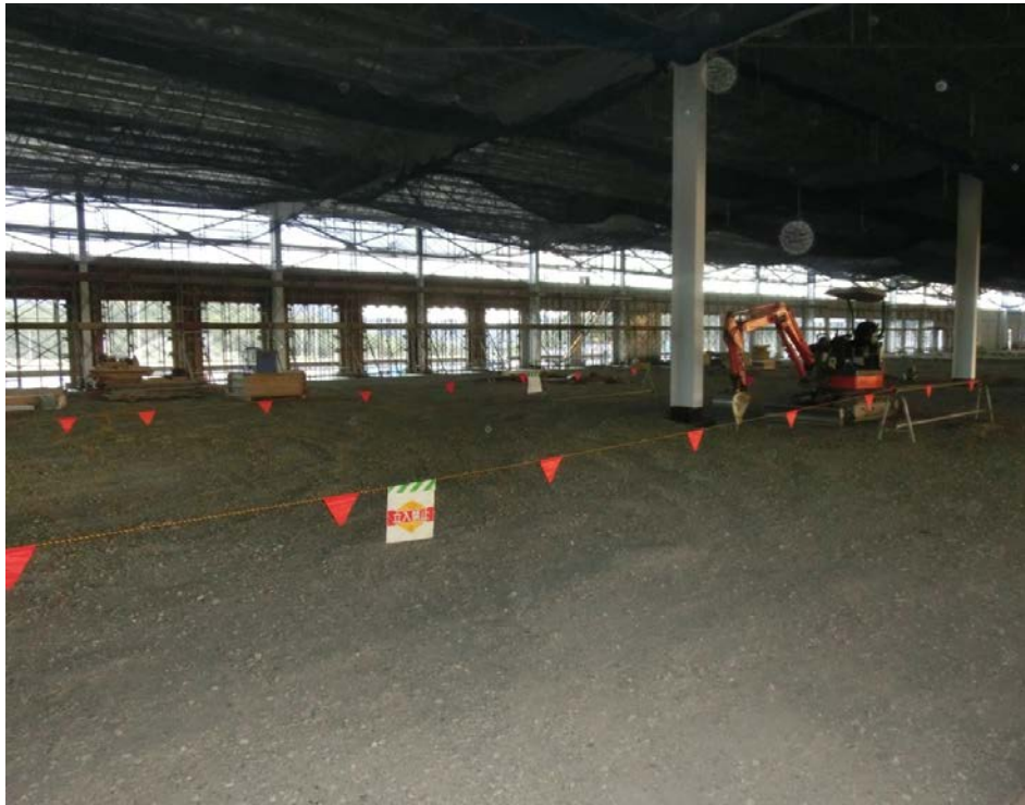
安全の見える化：立入禁止区画の明示（トラロープに赤い布を設置）
