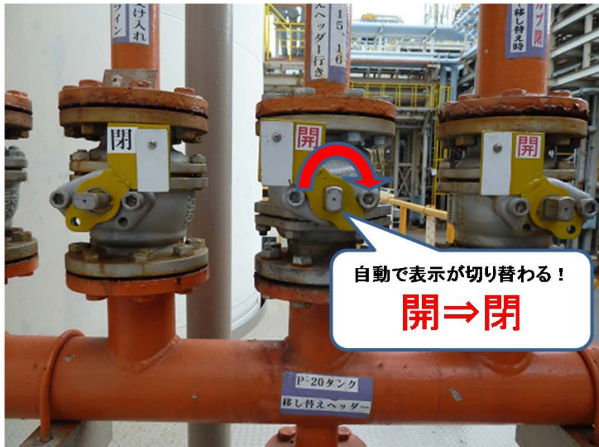
【手動ボールバルブの開閉表示】
