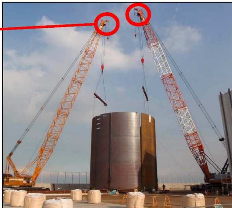
クレーンカメラ取付クローラクレーンによる施工状況
