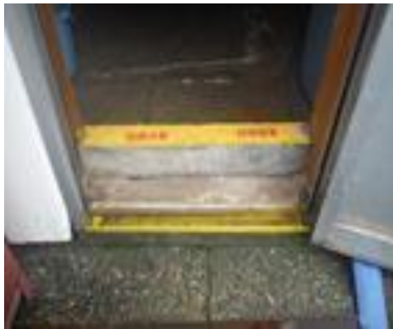
防液堤の踏み越え 躓き注意警告！
