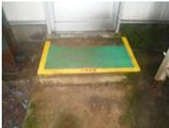
建屋からの出入り口の滑り止め！
