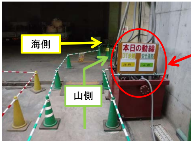
写真-動線明示看板設置状況
