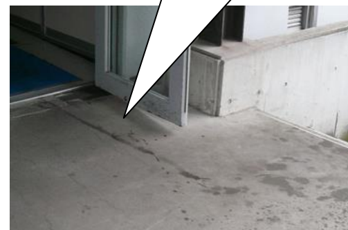
S2棟北口 保安側からの階段の上に 傘持込による水滴のあと
