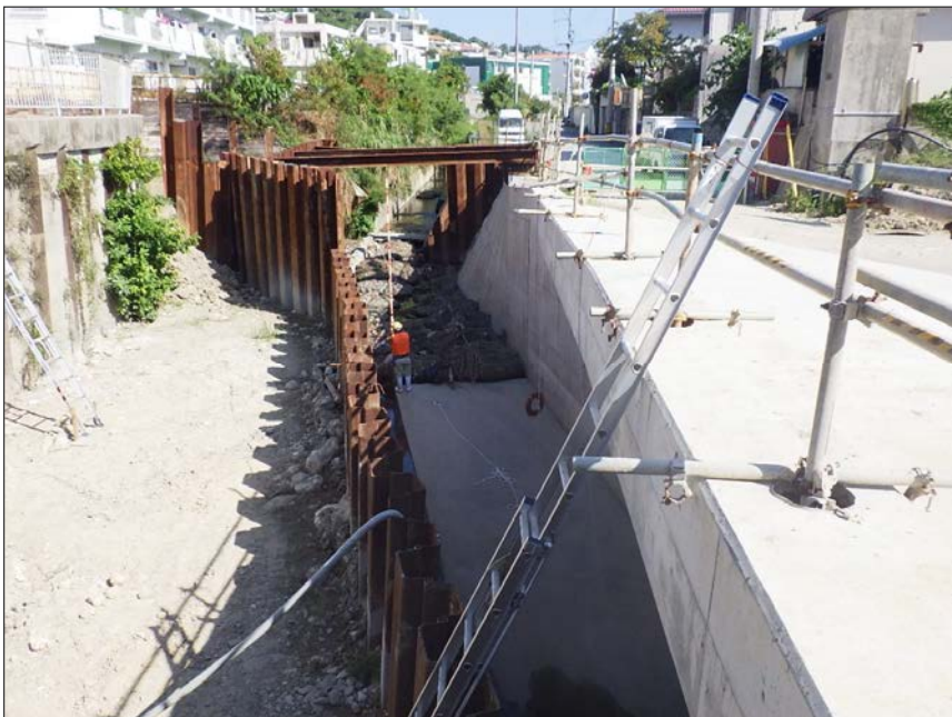
工種: 創意工夫 種別: 河川作業 写真タイトル: 河川における施工状況
