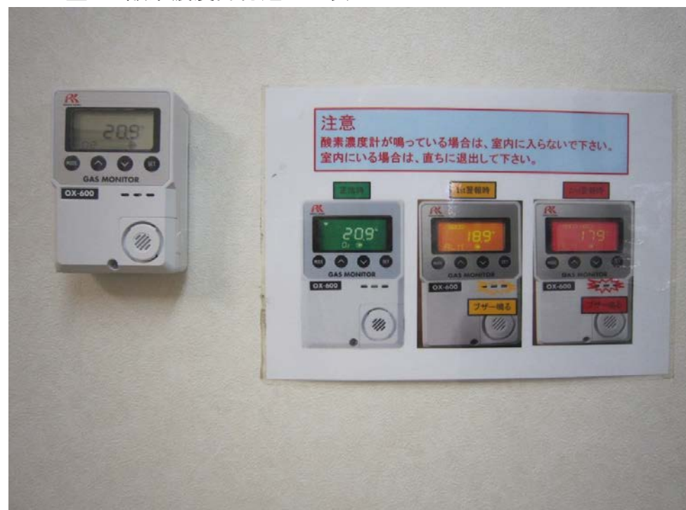
室内 酸素濃度計付近への表示
