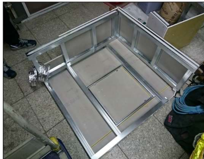
落下した内装材
